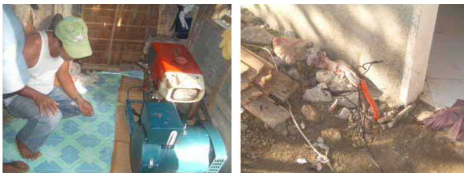
Unser 2nd hand Generator mit dem Kabelanschluss an Netz!
